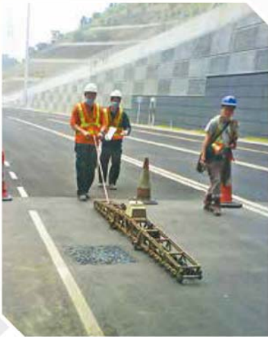
▲ 工務區域試驗所會安排地盤實地測試服務，包括土壤密度、馬路漆油的抗滑度和路面紋理深度及規律性等。
